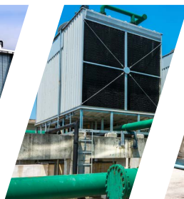
Tour de refroidissement
