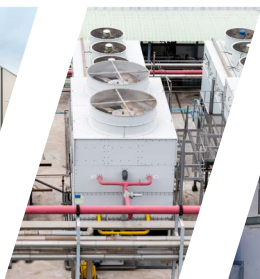
Groupes frigorifiques à refroidissement par eau
