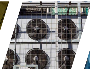
Murs de ventilateurs
