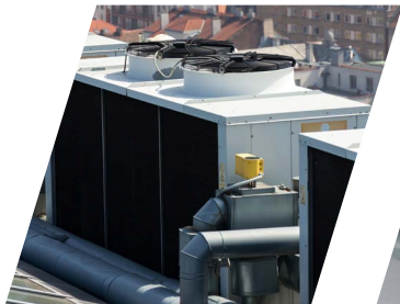
Bombas de calor
