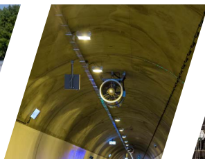
Ventilación de túneles
