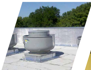
Ventiladores de tiro ascendente
